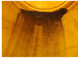
水洗浄排出痕①
