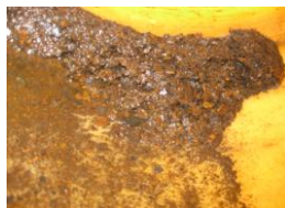
水洗浄排出痕②
